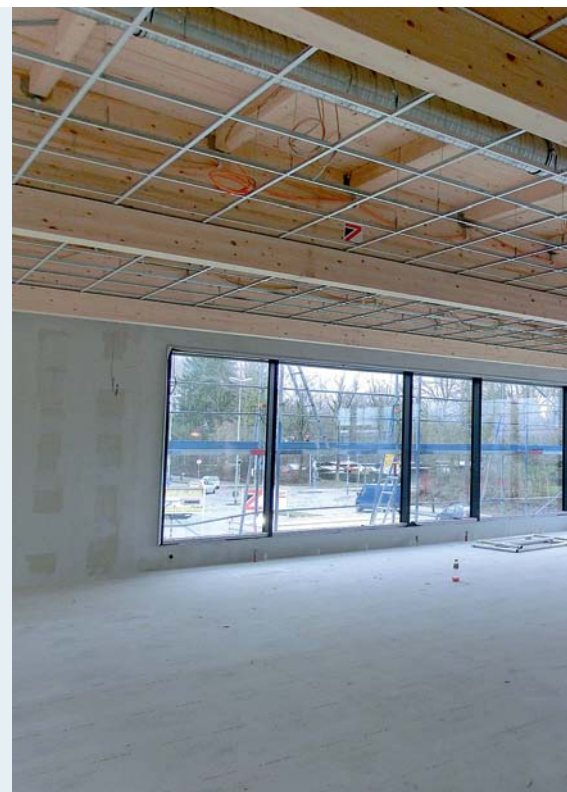
Durch eine abgehängte Akustikdecke werden auch von unten die schrägen Bauteile unsichtbar. Der Deckenhohlraum bietet Platz für Luft- und sonstige Leitungen.
