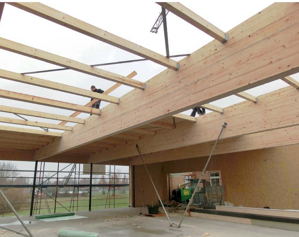
Das flach geneigte Dach bilden Pultdachbinder aus Brettspertholz. Eine umlaufende, rundum höhengleiche Attika lässt den Baukörper von außen dennoch als Quader erscheinen.
